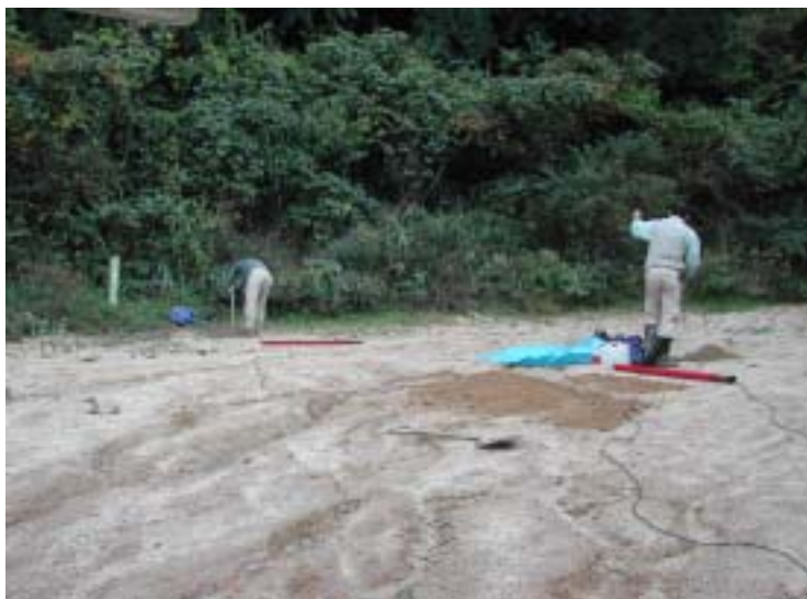
MT-8 観測装置設置作業
