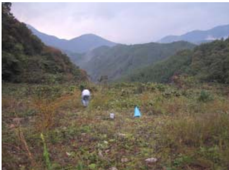
MT-13 観測装置設置作業
