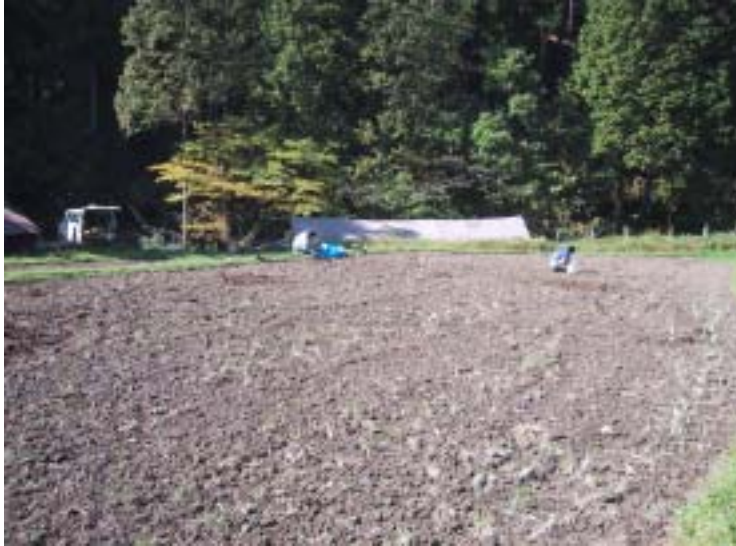
MT-11 観測装置設置作業
