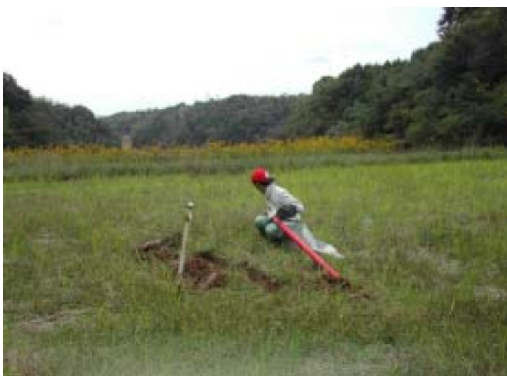
MT-5 観測装置設置作業
