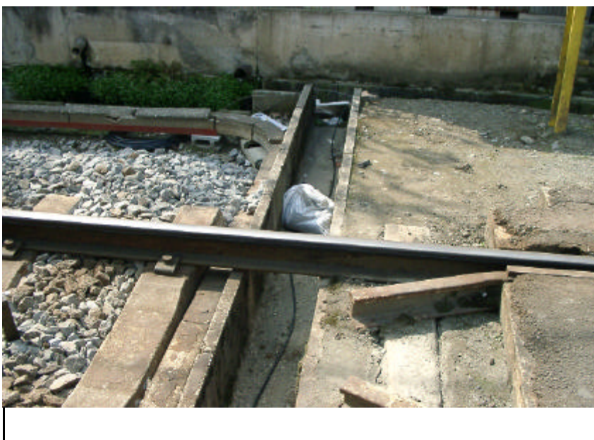
ケーブルの線路渡し 箱根鉄道大雄山線
