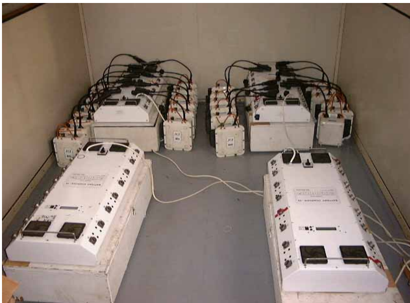
バッテリー充電ハウス
