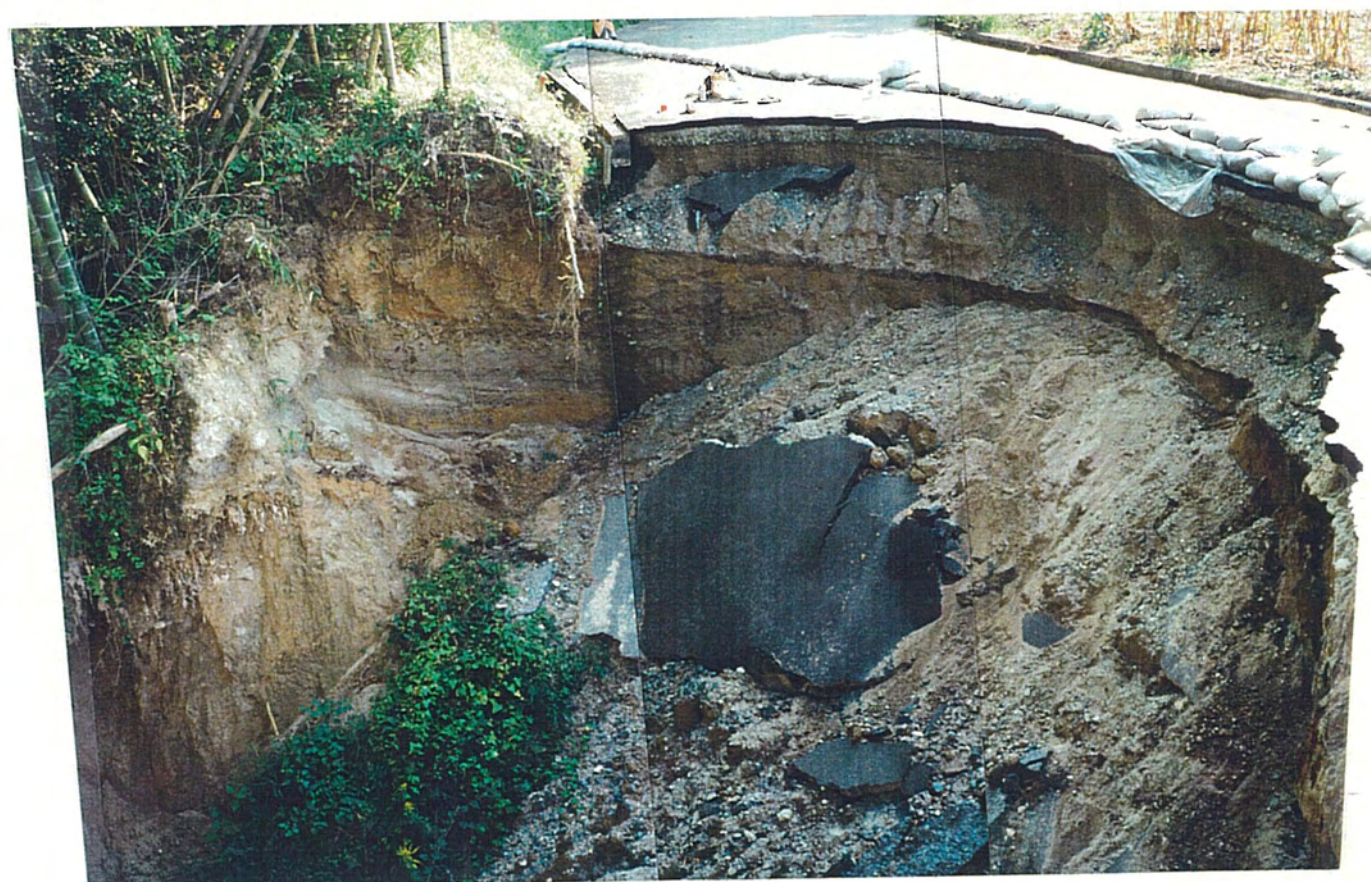
崩壊地北翼の傾斜部
