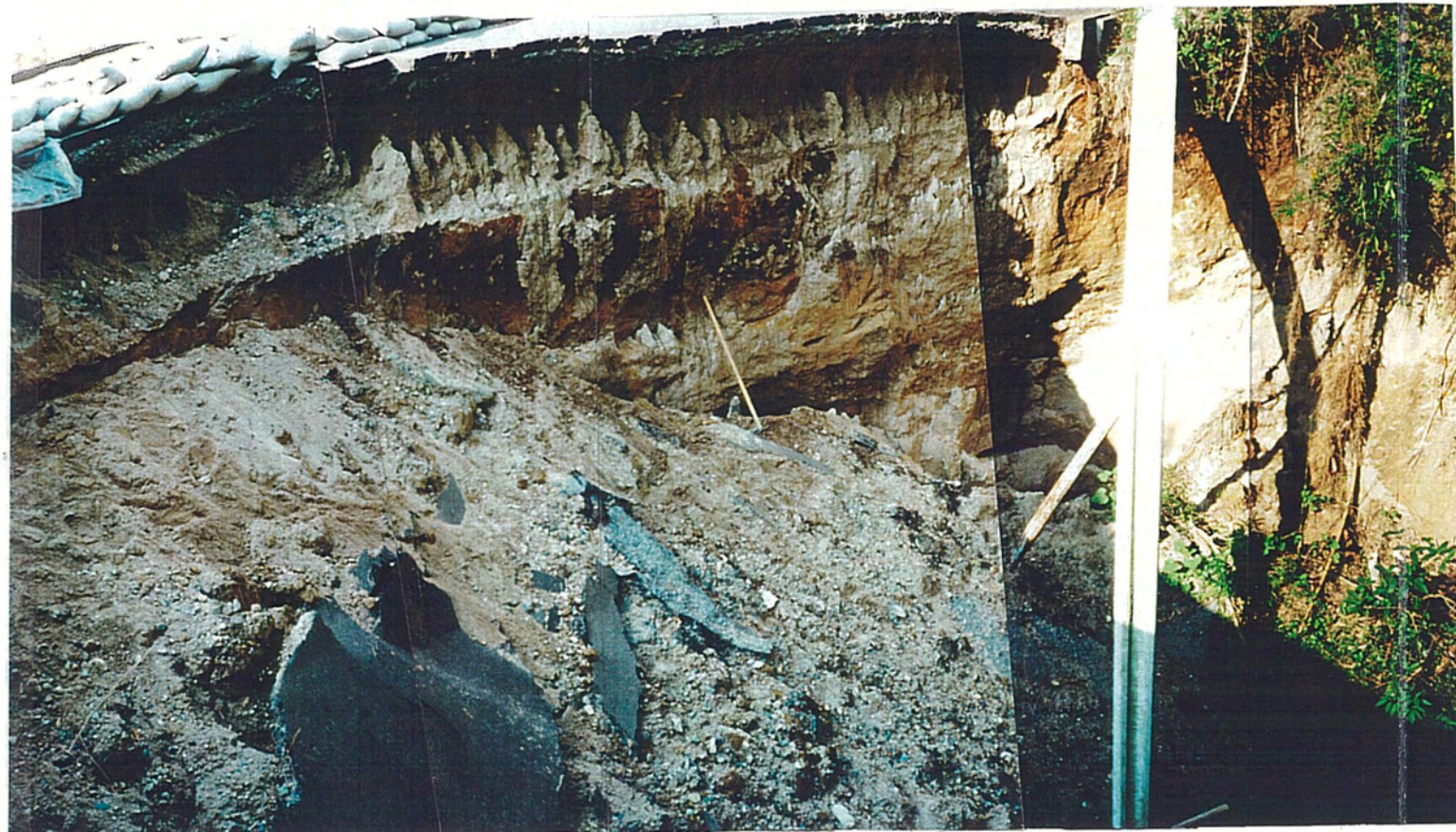
崩壊地南翼の水平部
